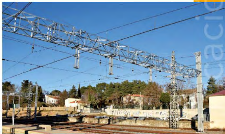
Sustitución de pórticos rígidos tipo Norte en la estación de Navalperal por nuevos pórticos rígidos.
