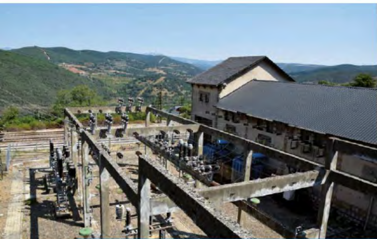
Subestación antigua en la línea Palencia-La Coruña (La Granja).
