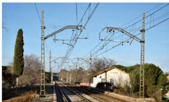
Un particular tipo de catenaria que solo está instalada entre Príncipe Pío y Las Rozas (Majadahonda).
