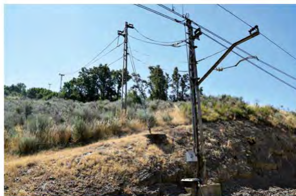
Feeder utilizado en los puertos de Pajares y La Granja para conectar con una misma subestación la parte alta y la parte baja del puerto.
