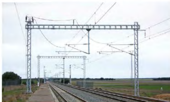
Catenaria 25 kV ancho Renfe. Pórtico rígido. (Cantalpino).
