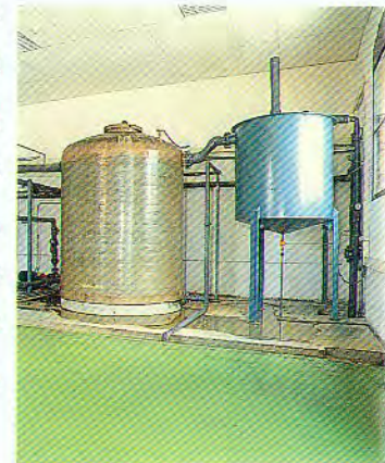
FOTO. TUNEL DE LAVADO: RECIKLADORA DE AGUA.
