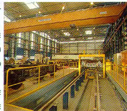
FOTO. BAJA BOGIES: VISTA GENERAL TALLER DE BOGIES: BANCO MONTAJE/DESMONTAJE
